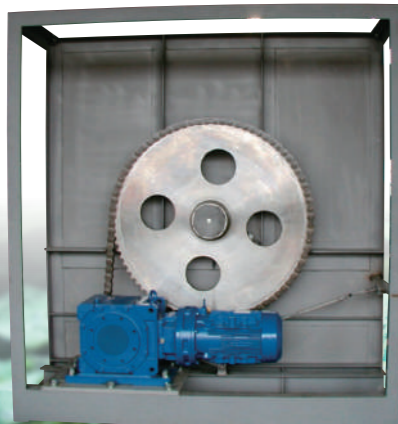
ギヤードモーター仕様機械室
