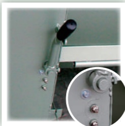
油注入口(機械室外)
